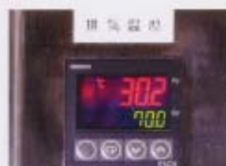
給気/排気温度管理
